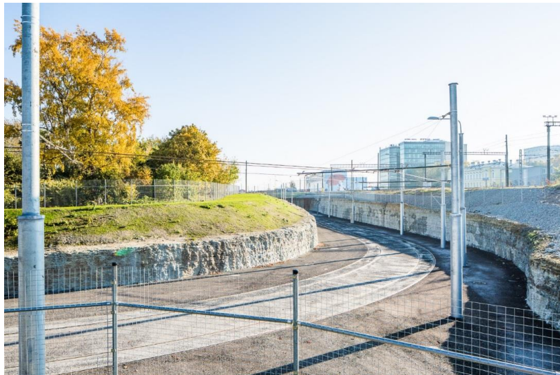
Pilt 11. I vooru projekti tulemusena rajatud trammide tagasipöörde ring Ülemiste jaama juures. Järgmise etapina rajatakse raudtee alla tunnel, mille kaudu pikeneb trammiliiklus kuni lennujaamani.
